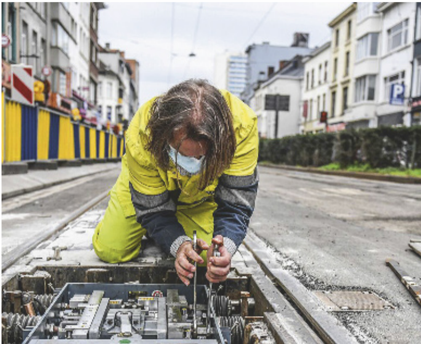
Tramtechniekster Roy ontfermt zich samen met zijn collega over de seinen, wisselsturingen en bovenleidingen in de stad.
